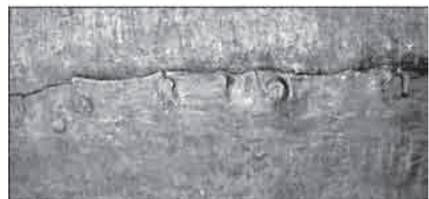
Рис. 6. Сліди вирізання шматочків металу в місцях утворення гофрів
